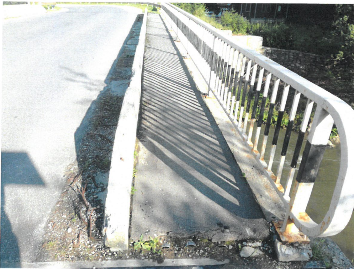
Foto nr. 11 – Lipsa parapetului de siguranță și/sau a unor elemente din parapetul podului
