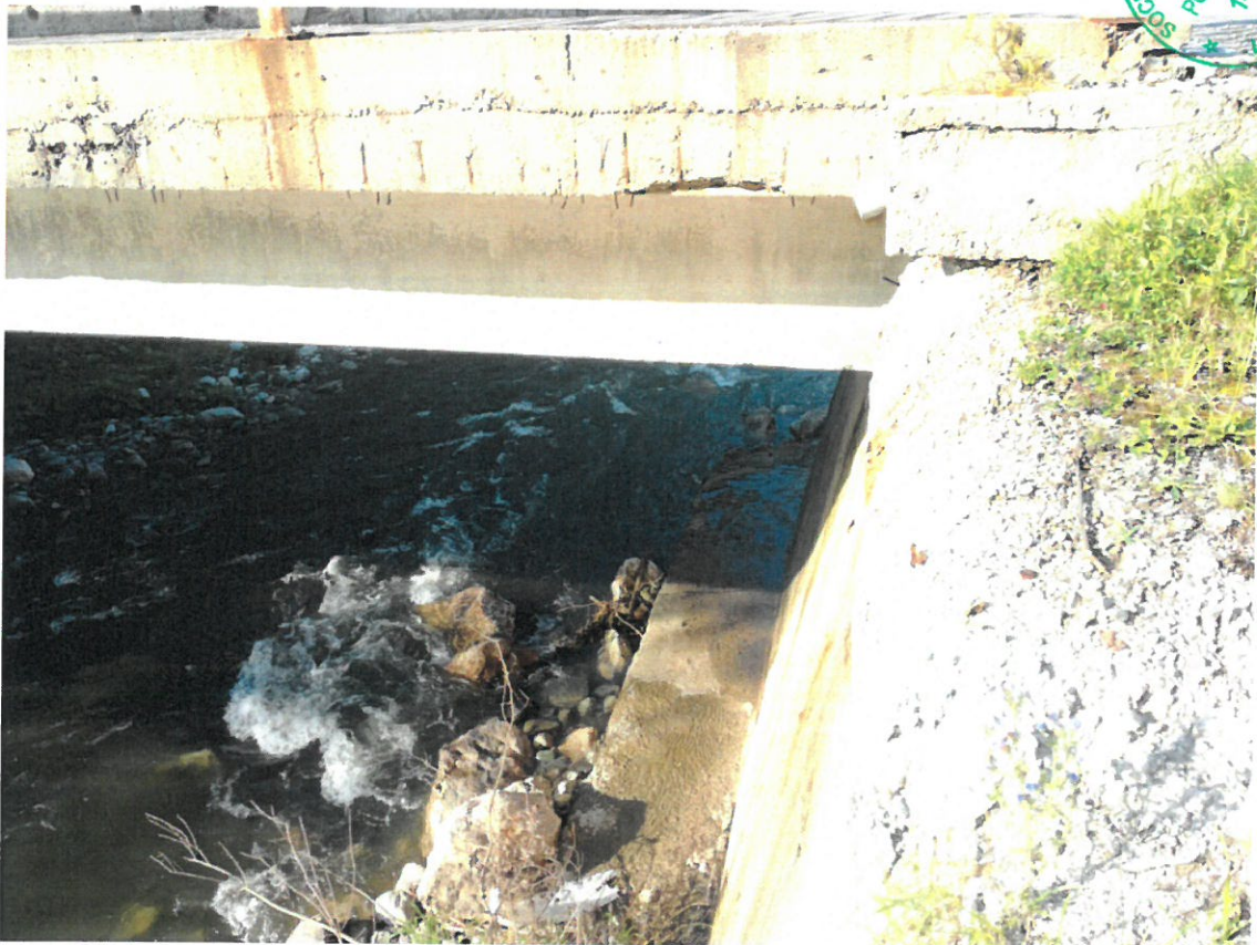
Foto nr. 2 – Armături fără strat de acoperire
