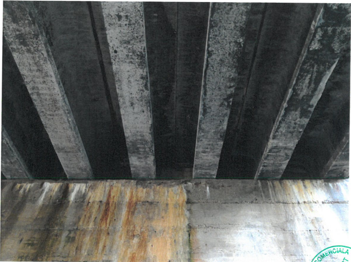
Foto nr. 1 - Beton degradat prin carbonatare
