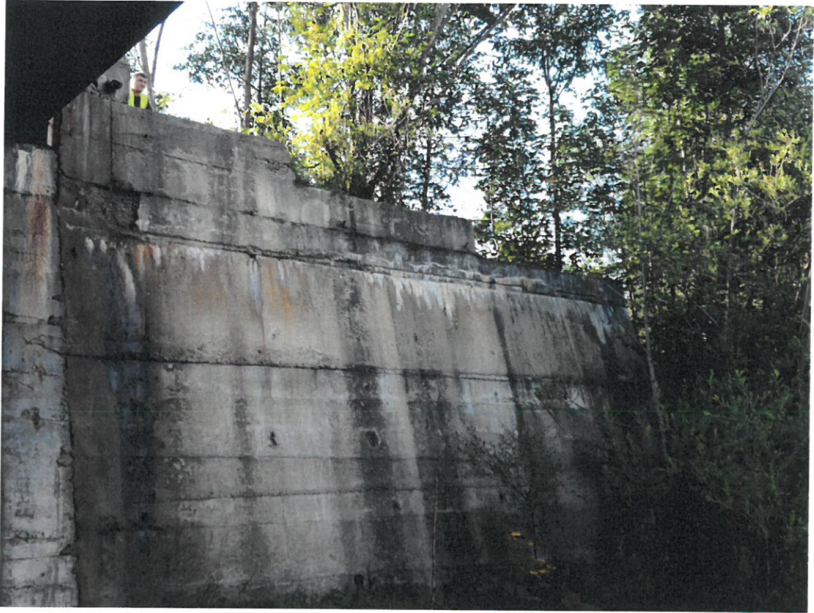
Foto nr. 5 - Cumularea la un element al structurii a mai multor degradări (coroziunea betonului și a armăturii, exfoliere, fisuri, crăpături, striviri) care se manifestă prin modificarea formei elementului și a proprietăților fizico-mecanice ale materialelor
